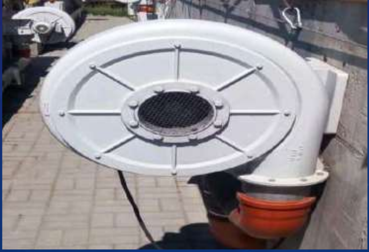
Ventilator za aeraciju
