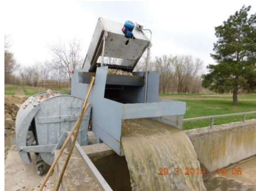
Slika: Izlivna građevina privremenog „by-passa“ sa finom rešetkom
