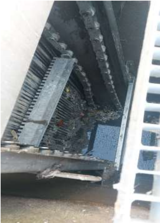
Slika: Havarija na ulaznoj gruboj rešetki
