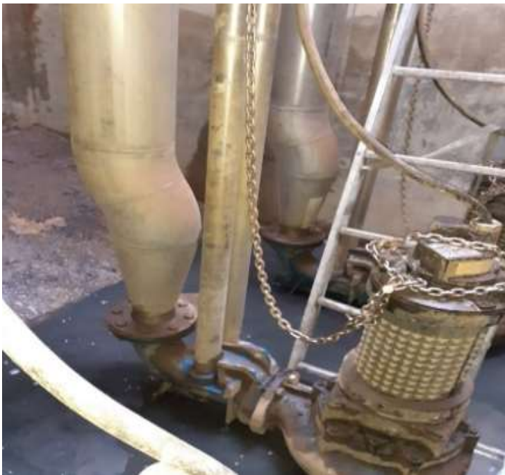
Slika: Ulazna CS sa novim muljnim pumpama
