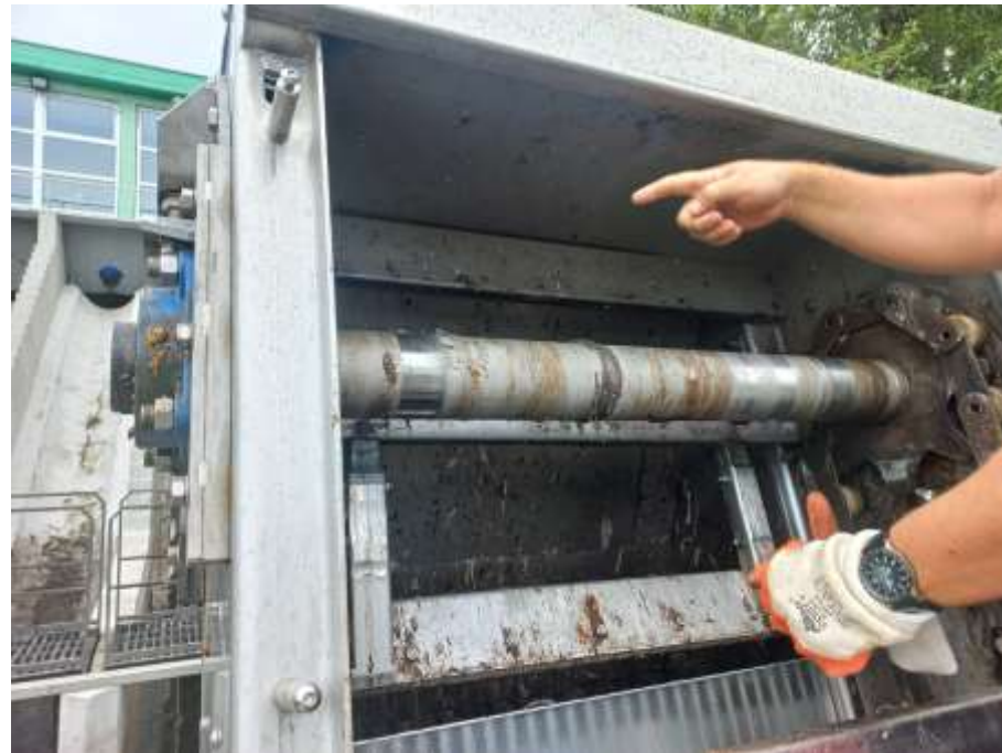
Slika: Havarija na ulaznoj gruboj rešetki
