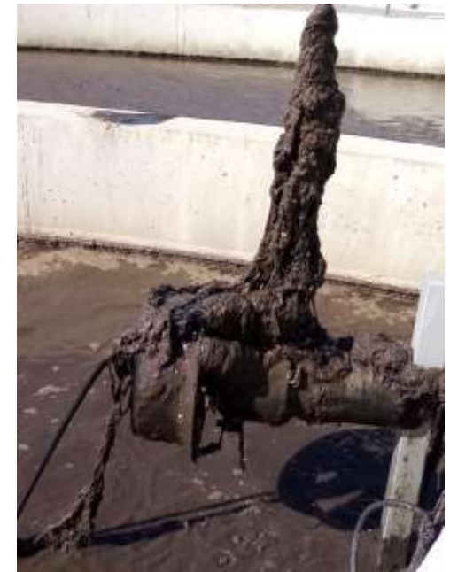
Slika: Havarija na brzohodnom mikseru u denitrifikacionom bazenu
