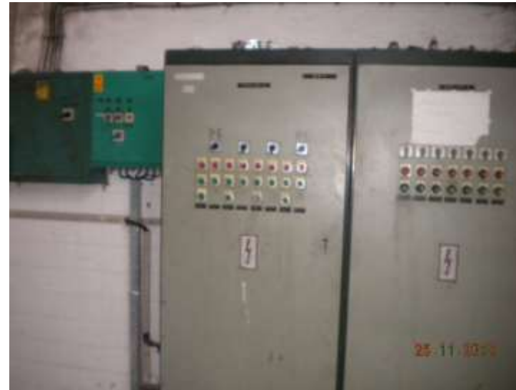
Slika: Stari elektro ormani objekat za recikulaciju mulja
