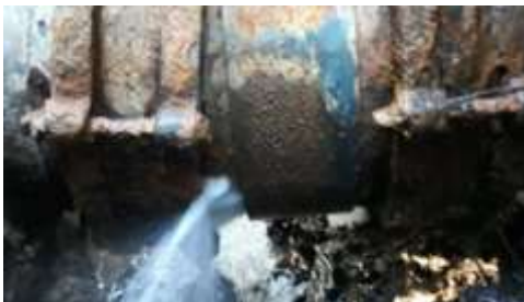
Izgled oštećenja postojeće spojnice uz prikaz ugaonog odstupanja
