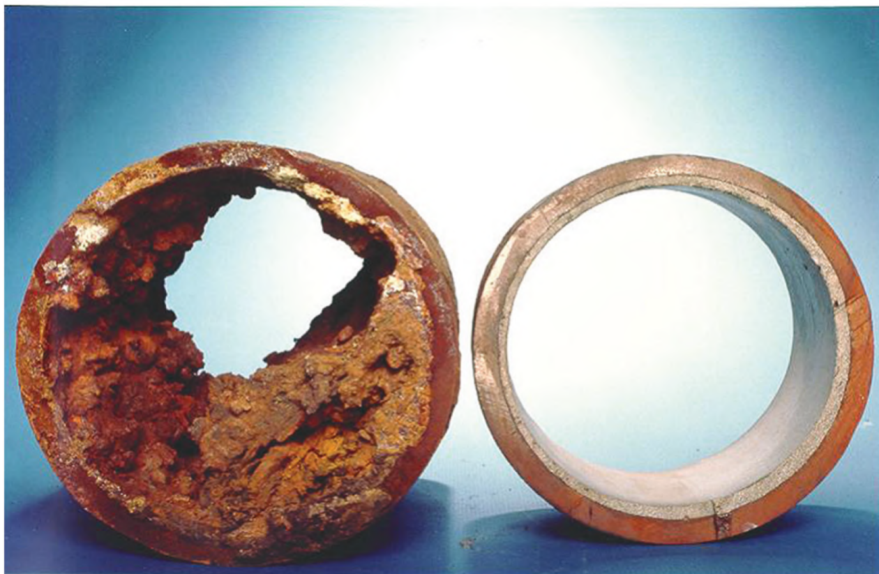
Slika 2. Izgled vodovodne cevi posle 50-60 godina eksploatacije
