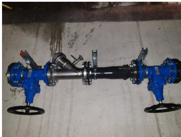
Slika 4. Uređaj za ispiranje „SpülProbi“ ugrađen u kućni priključak za vodu za piće
